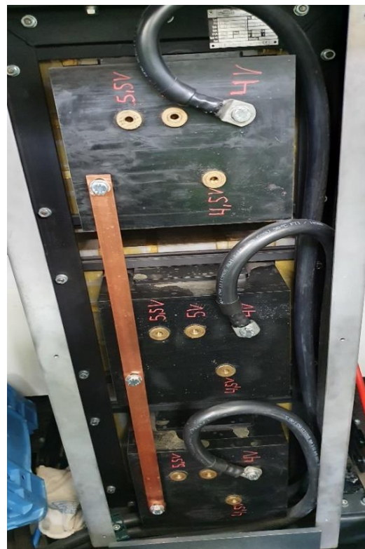
ABBILDUNG 1 - Trafo-Anzapfungen an einer DSP 520.
